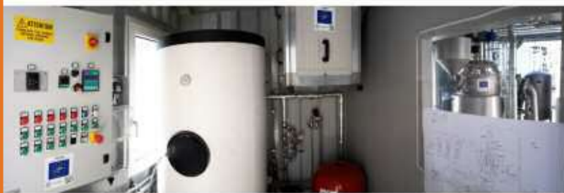
Sezione di trattamento Fisico: camera di controllo
