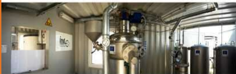
Sezione di trattamento Fisico: camera operativa
