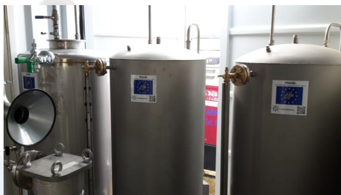
Serbatoi di stoccaggio
